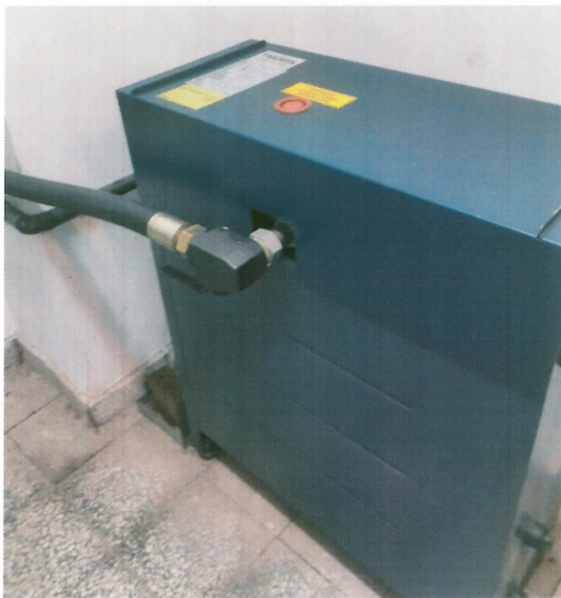
Zdj. nr 5 – Agregat hydrauliczny.
