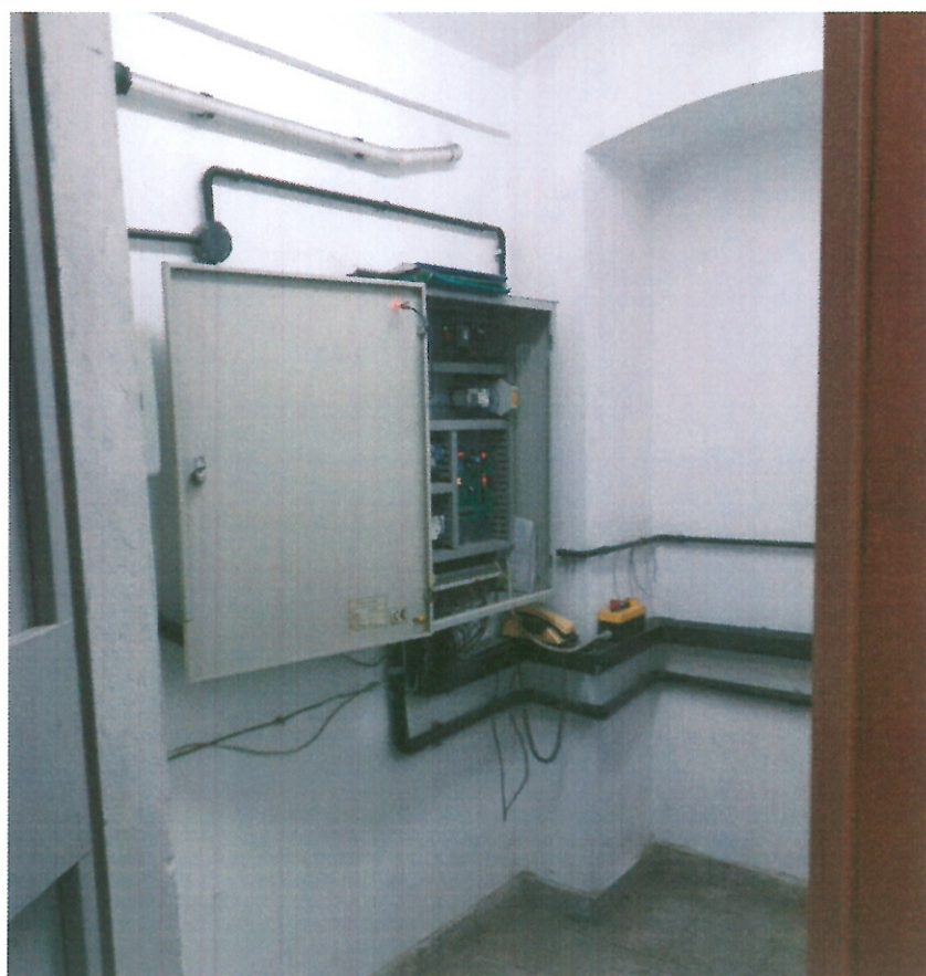
Zdj. nr 4 – Maszynownia.
